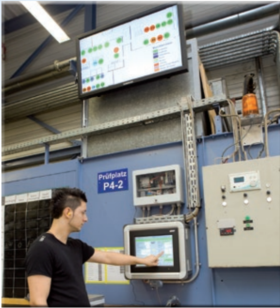
Alles aus einem System: Dateneingabe am Shopfloor Terminal und Information für alle am großen Flachbildschirm direkt in der Fertigungshalle.
